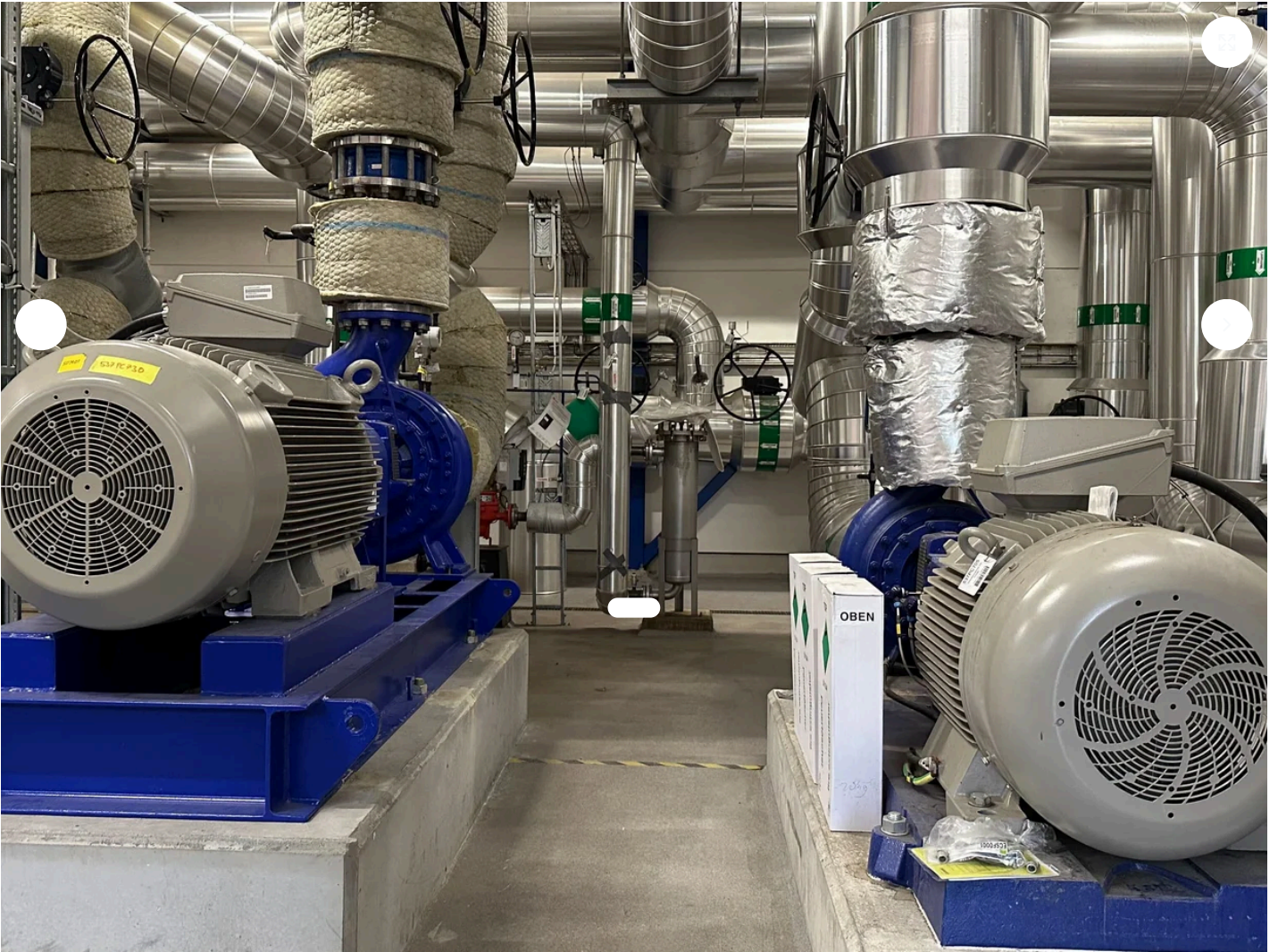
Hjärtat i anläggningen. Pumpen till vänster skickar ut värme i Arboga och pumpen till höger skickar värme till Köping. Bild: Fredrik Klevenhaus
