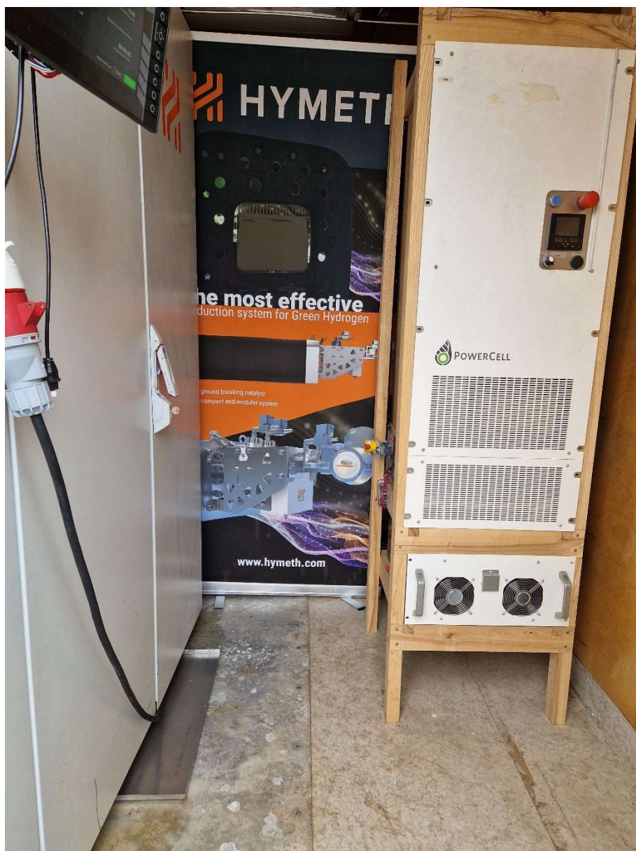
Elektrolysören från Hymeth används för produktionen av vätgasen. Anläggningen har projekterats av Hans-Olof Nilsson.
