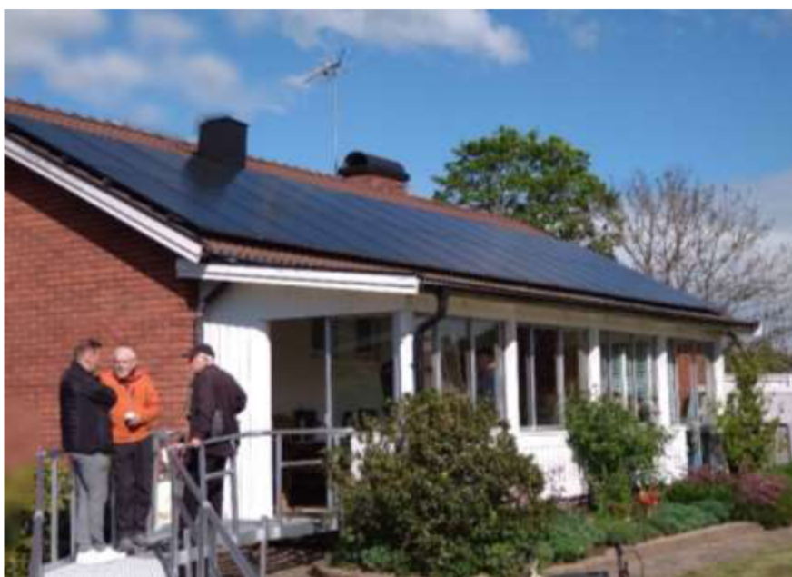
Solceller med toppeffekt 10,5 kW hos Carl Olov och Else-Gun Persson i Köping. Batteriet i källaren på 5 kWh är bara som en liten garderob.
